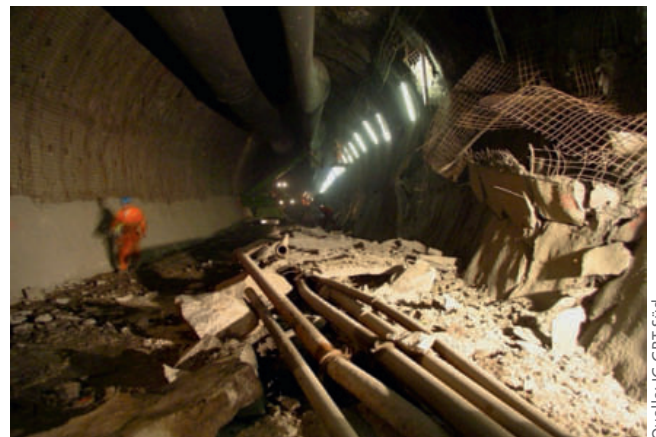
► Bild 1 Folgen eines Bergschlags im Teilabschnitt Faido
