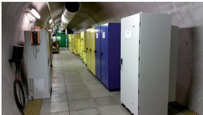
Fig. 11. Equipment of a cross passage in the GBT (photo: IGBT Süd) Bild 11. Ausrüstung eines Querschlags am GBT (Foto: IGBT Süd)
