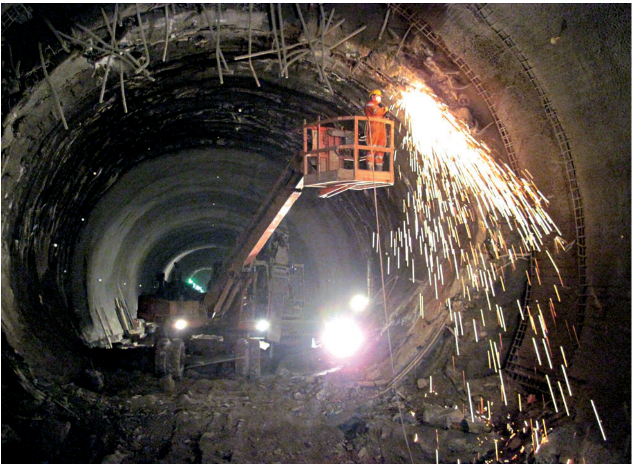
11 Nachprofilierungsarbeiten Störzone 50/50b im Vortrieb Sedrun Süd bei km 125.475 Reworking operations for fault zone 50/50b in the Sedrun South drive at km 125.475
