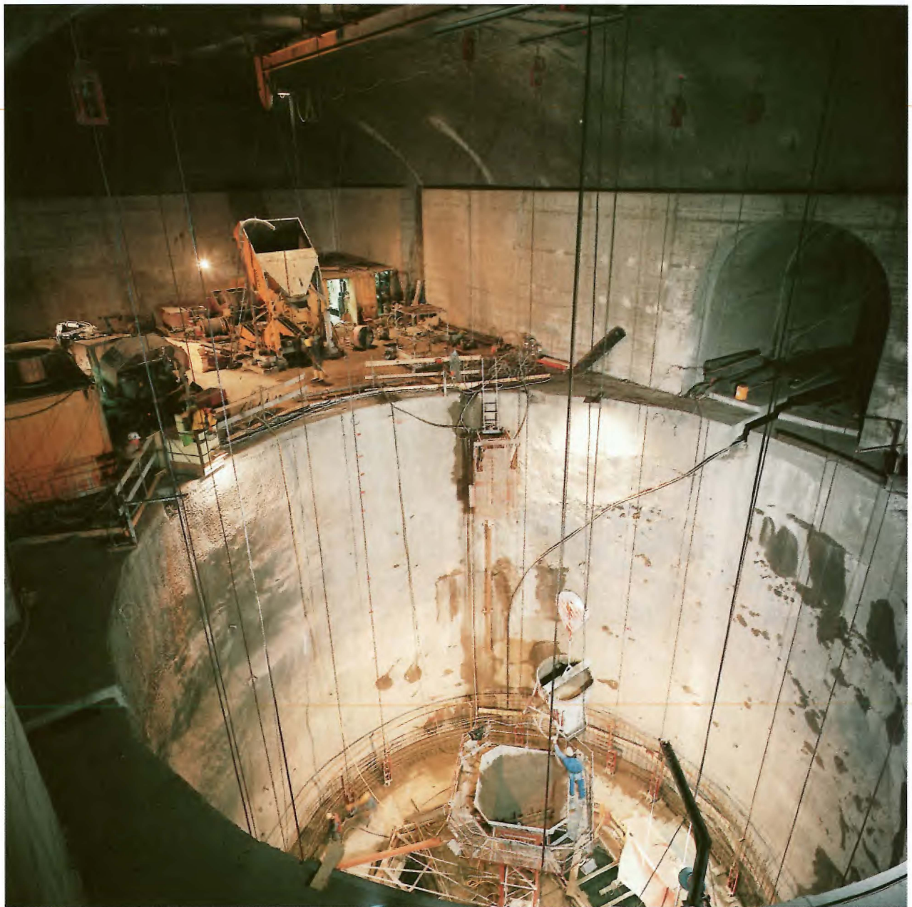
Bild 5.3. Die Betonauskleidung des Vertikalschachtes erfolgte mittels Gleitschalung vom Schachtfuss nach oben. Zur Abdichtung des Schachtes ist eine Dichtungsfolie auf den mit Gunit geschützten Fels aufgebracht worden (Foto Wolf, Schruns).
