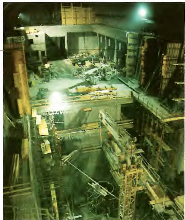
Bild 6.9. Der Innenausbau der Kaverne Martina ist eine anspruchsvolle Aufgabe, die bei engen Platzverhältnissen bewältigt werden musste.
