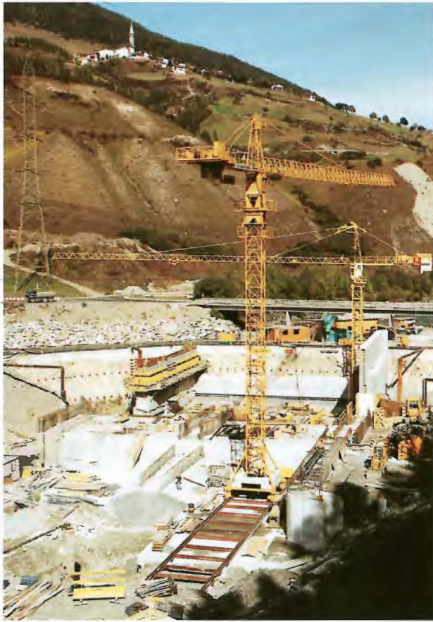
Bild 3.7. Wehranlage im Bau (Stand November 1991), Blick flussabwärts. Im Hintergrund Zufahrtsbrücke zur Zentrale Pradella und Dorf Sent.
