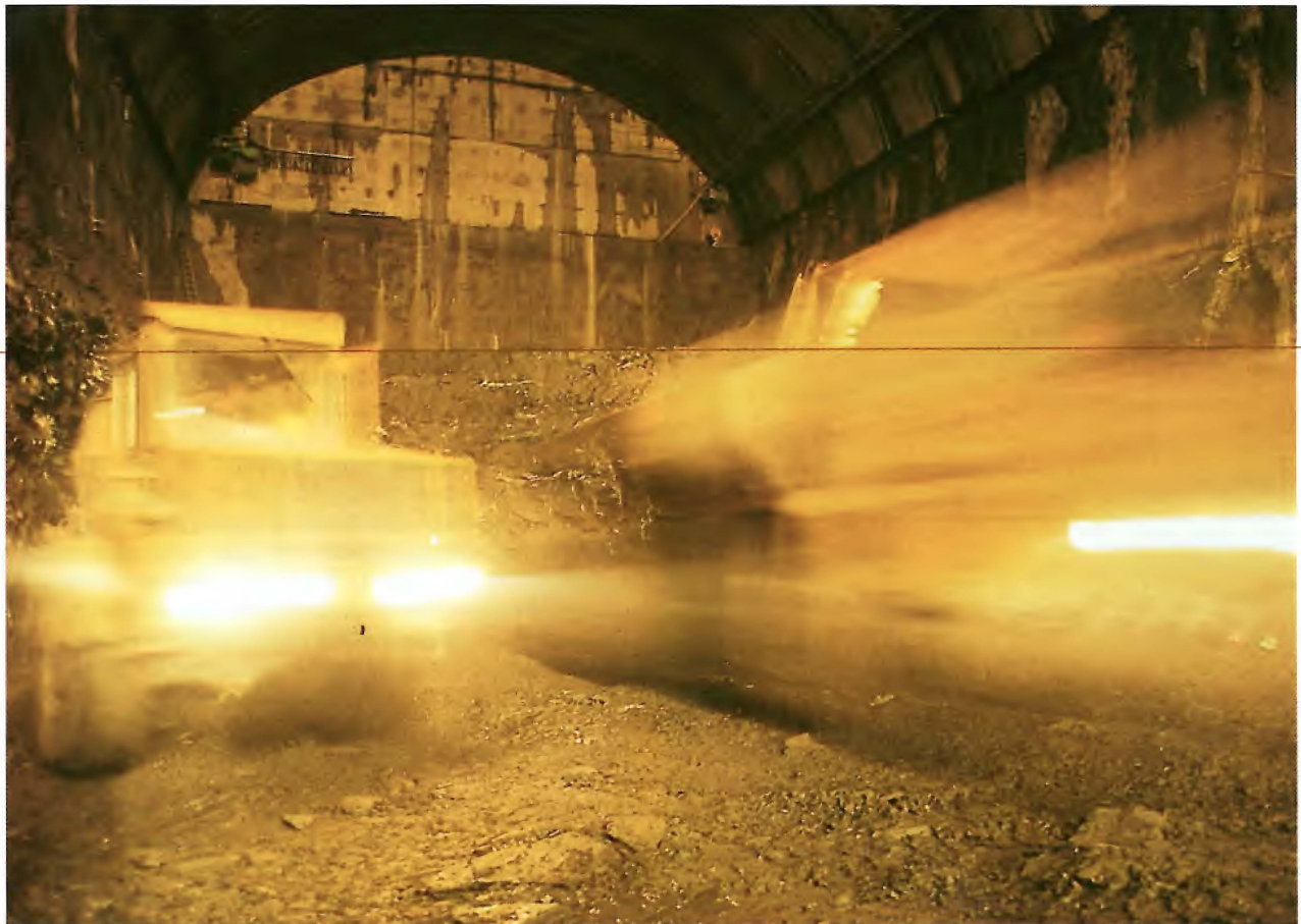
Bild 6.8. Ausbrucharbeiten in der Kaverne. In der Zeit vom Februar 1991 bis September 1991 wurde die Kavernenzentrale mit einem Volumen von etwa 40000 m 3 (fest) ausgebrochen. Das Bild gibt einen Eindruck vom regen Baustellenverkehr, der in dieser Zeit herrschte. Im Hintergrund ist das bereits fertiggestellte Ortsbetongewölbe zu erkennen.
