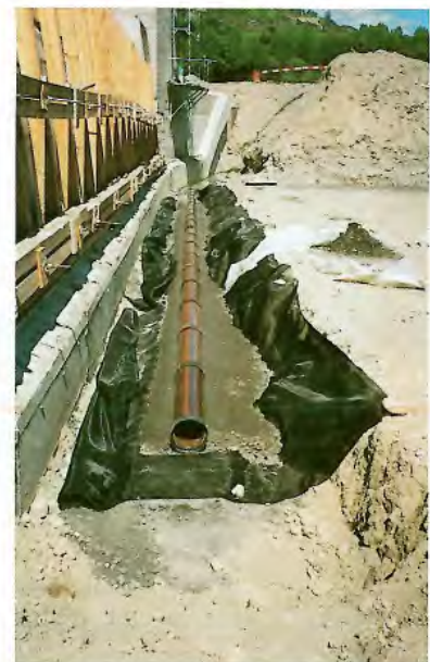
Bild 3.11. Querdrainageleitungen führen allfällige Sickerverluste zu den beiden begehbaren Sammelkanälen. Bedingt durch die grosse Aggressivität des Grundwassers, sind Steinzeugrohre verwendet worden.
