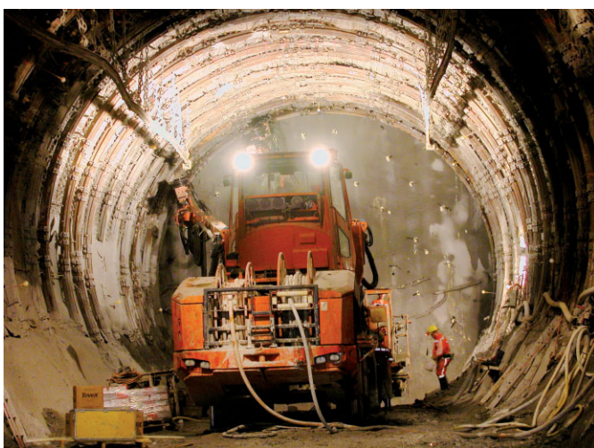
Fig. 3. Conventional tunnelling in squeezing rock in Sedrun Bild 3. Konventioneller Vortrieb im druckhaften Gebirge in Sedrun
